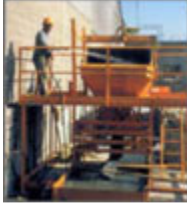
► Système de récupération des laitances du béton
